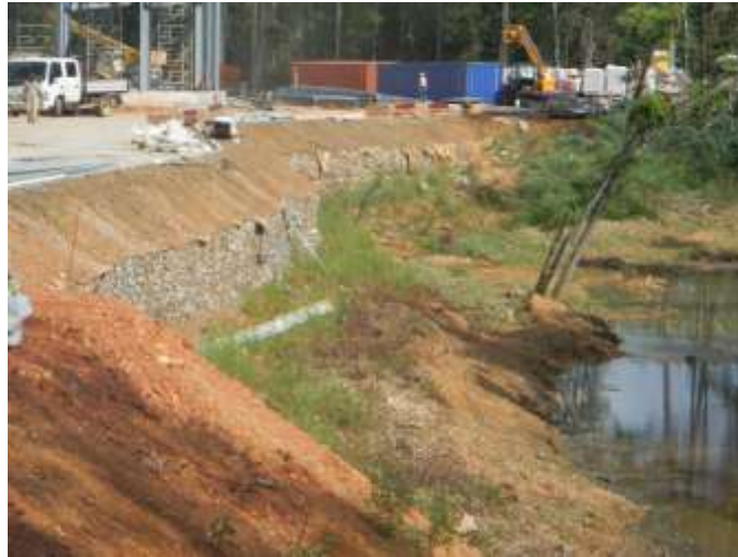
Fig. 11. AMÉNAGEMENT DE BERGE EN GABION LE LONG DE LA CRIQUE BALATA, DERRIÈRE LE FAMILY PLAZZA
