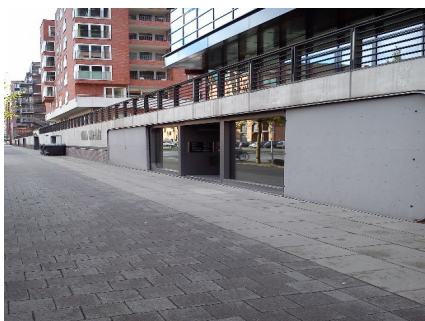
Une porte batardeau qui protège l'entrée de parking lors d'une inondation
